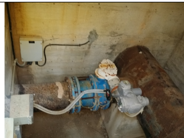
INTERNO CAMERE DI MANOVRA E.S.A.
