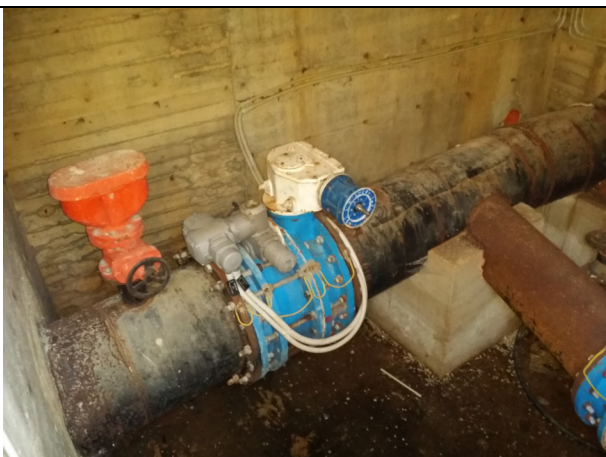
INTERNO CAMERE DI MANOVRA E.S.A.
