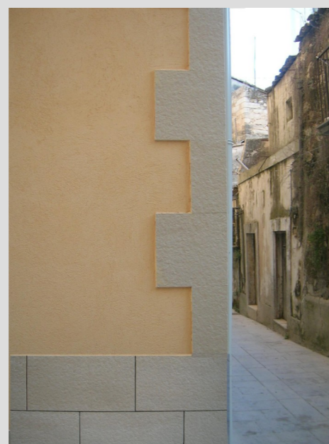
EDILIZIA DI BASE T1: APPLICAZIONE LASTRE IN PIETRA CALCAREA BUGGIARDATA A FORMA RETTANGOLARE CON LATO MAGGIORE POSTO IN ORIZZONTALE, RIVESTIMENTO SPIGOLO CON LASTRE POSTE A DENTE DI SEGA SOLUZIONE INADEGUATA NELLO SCHEMA COMPOSITIVO E NELLE CARATTERISTICHE MATERICHE
