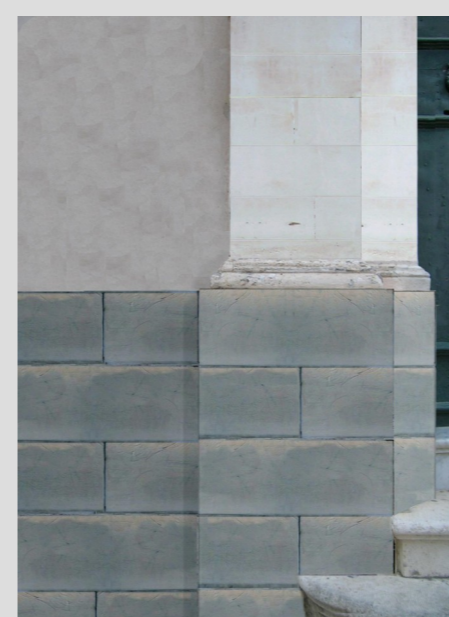
PALAZZO T3: INSERIMENTO CONCI IN PIETRA CALCAREA LISCIA A FORMA RETTANGOLARE CON LATO MAGGIORE POSTO IN ORIZZONTALE, A GIUNTO SFALSATO
