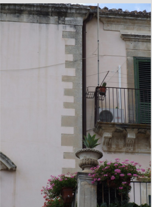
INTONACO SU FRONTE PALAZZO CON RIFINIZIONE A DENTE DI SEGA IN RILEVATO, SOLUZIONE INADEGUATA E NON COERENTE CON LE CARATTERISTICHE TIPOLOGICHE DEL CENTRO STORICO
